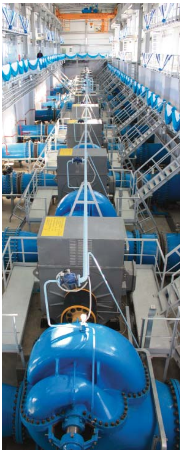
Фото 3. Машинный зал насосной станции
